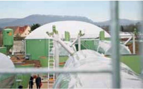
E.ON Westfalen Weser engagiert sich bei der Gewinnung von Bioerdgas aus Biomasse und dessen Nutzung zur Kraft-Wärme-Kopplung.
